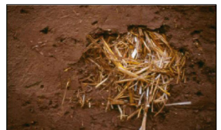
Abb.9 Mit dem Schleuderverfahren aufgebracht, schlecht haftender Lehmputz
